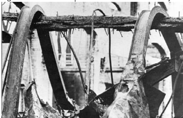
Figura 23. Vigas de madeira suportando estruturas de aço deformadas.
